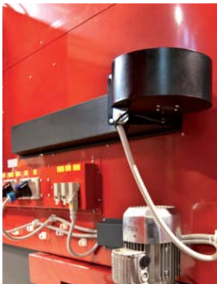
Ventilator aer secundar
