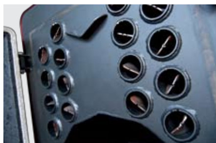
Extractor cenusa: schimbator de caldura
